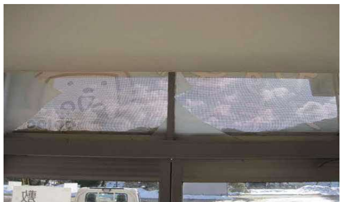
東比田交流センター 1階玄関 ガラス割れ
