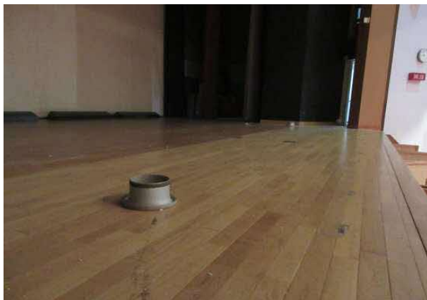
広瀬交流センター 2階ホール 部品落下
