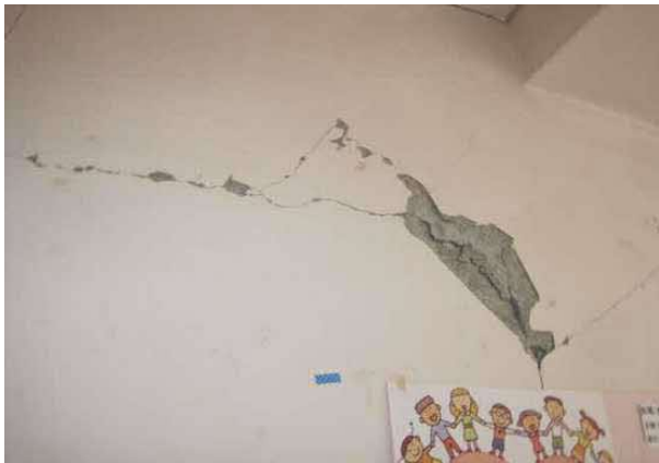
東比田交流センター 壁面割れ
