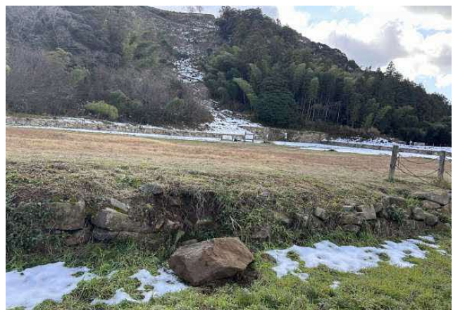
月山富田城 石垣崩れ
