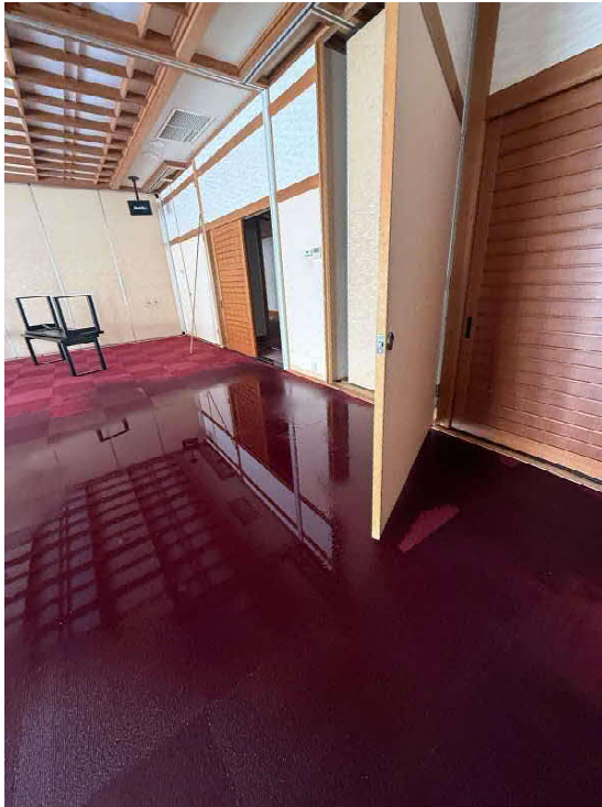
夢ランドしらさぎ 宴会場天井の配管から水漏れ
