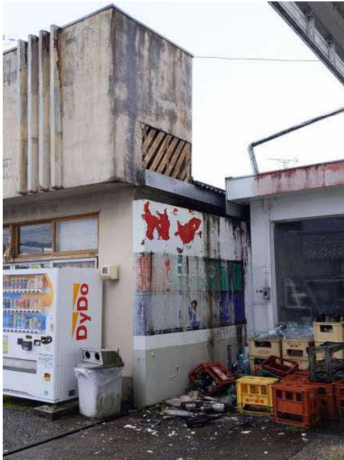
広瀬イエローバスターミナル 外壁落下
