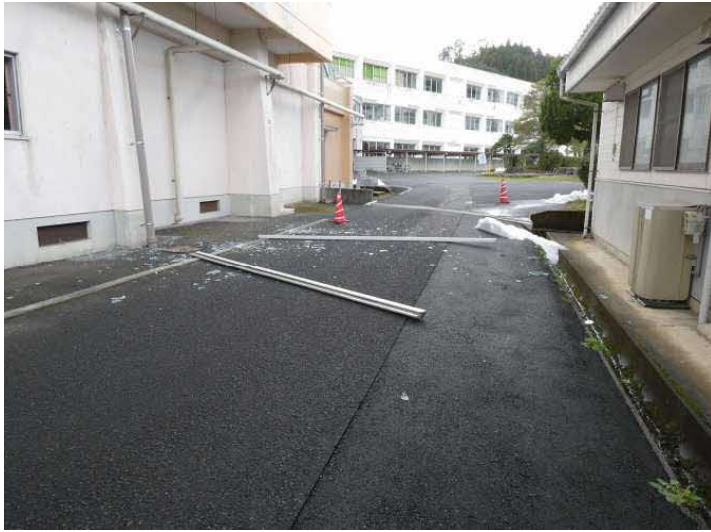
伯太体育館 窓ガラス・サッシ枠
