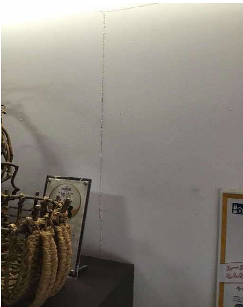
道の駅あらえっさ 中海の郷 壁面亀裂
