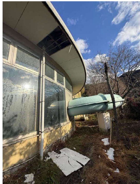
夢ランドしらさぎ 屋根一部落下
