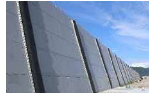
＜防波壁(海拔15m、延長1.5km)＞
