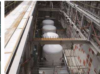
＜フィルタ付ベント設備＞
