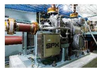
＜高圧原子炉代替注水ポンプ＞
