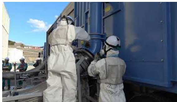
原子炉補機代替冷却系 （移動式代替熱交換設備） へのホース接続
