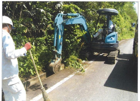
廻谷中谷線土砂撤去
